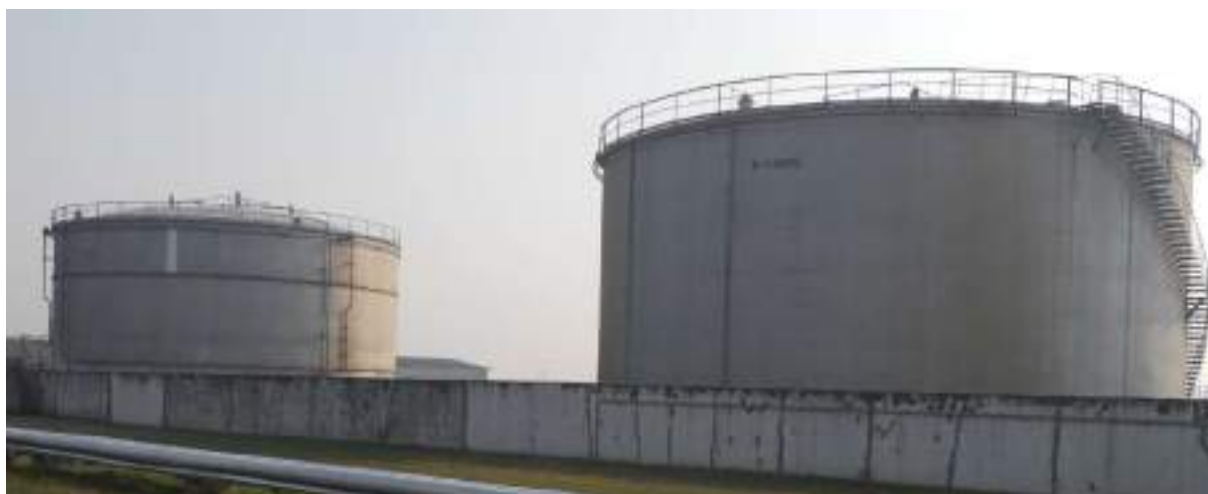
Slika 1.30 Spremnici za skladištenje nafte s fiksnim krovom
